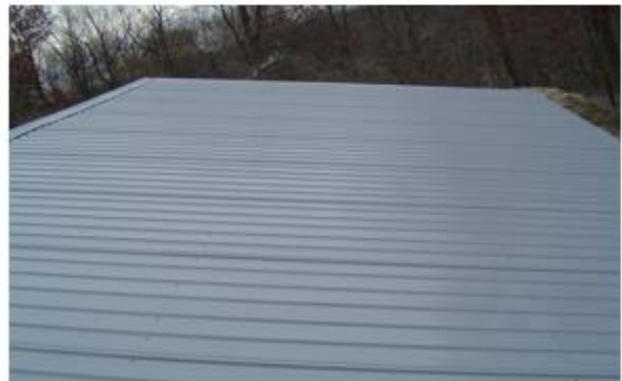
Figura 13 Techo recubierto con GE Enduris
