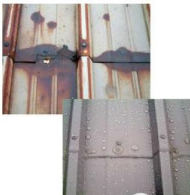
Figura 5 Los paneles con corrosión superficial se pueden recubrir con GE Enduris
