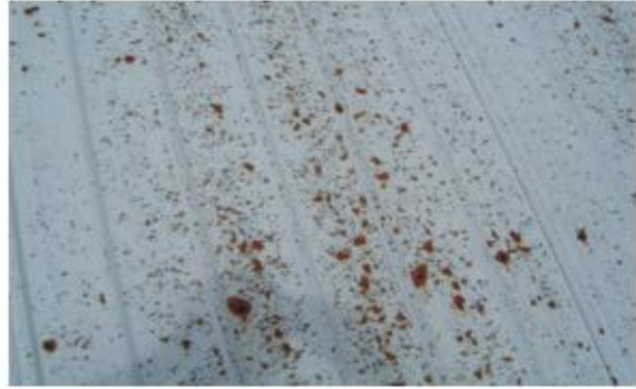
Figura 5 Oxido en techo metálico
