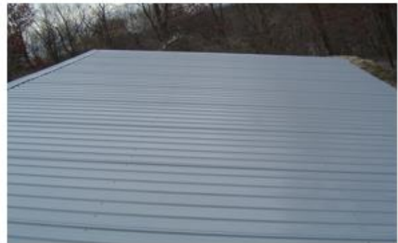
Figura 13 Techo recubierto con GE Enduris
